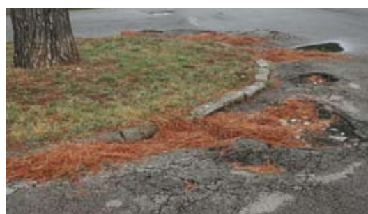
S. M. degli Angeli, via Raffaello dal n. 12 al n. 16 le radici rendono pericoloso il manto stradale
