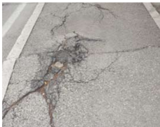
Santa Maria degli Angeli. Marciapiede incrocio via Los Angeles e via Diaz adiacente alla fermata degli autobus. Il degrado persiste da due anni
